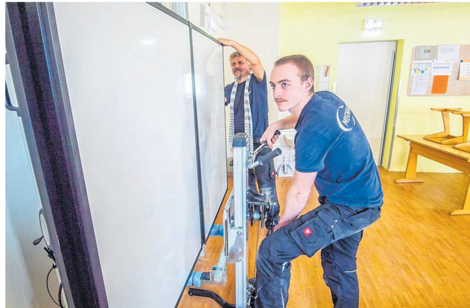
Die Systemtechniker Toralf Kramer und Roman Zierold (von links) bauten in den vergangenen Tagen neue Tafeln in der Grundschule Jahnsdorf auf.
